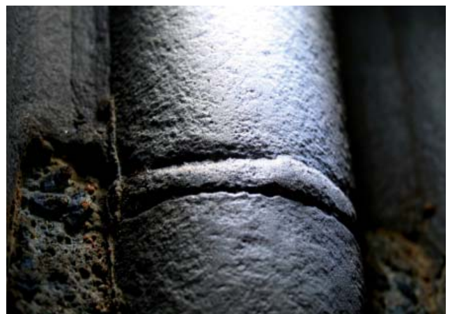
Abbildung 8: Korrosion entlang der Wärmeeinflusszone (WEZ) einer überhöhten Schweißverbindung. Die linke Rohrflanke steht in Richtung der Kernströmung. Rohr und Naht sind dort stärker abgezehrt. Das weist auf den Einfluss der Wärmestromdichte hin.
