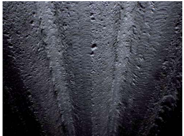
Abbildung 6: Einseitige Korrosion der rechten Rohrflanke, die „das Feuer sieht“; die linke Rohrflanke ist „wie neu“. Beleg für den Einfluss der Wärmestromdichte auf die Korrosion.
