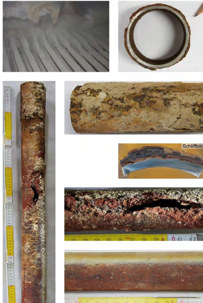
Bild 8: Korrosionsdurchtritt am LUVO kurz nach Eintritt der Luft. Dicke Beläge mit Calciumchlorid unmittelbar am Eintritt (einsetzende Korrosion im Schliffbild dargestellt), in etwas weiterem Abstand der korrosive Durchtritt, im weiteren Abstand keine Abzehrung mehr. Für das Bewerten und Entschärfen von Situationen dieser Art bietet sich ein Korrosionsmonitoring an.
