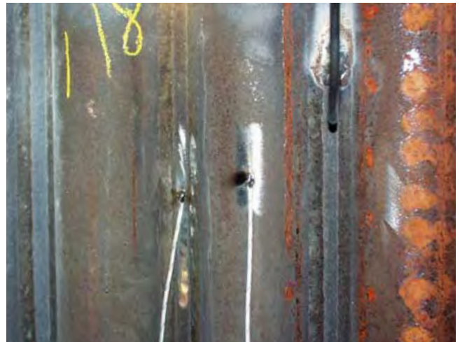
Bild 2: Auf der Außenseite angebrachte Thermoelemente zur Messung der Wärmestromdichte.
