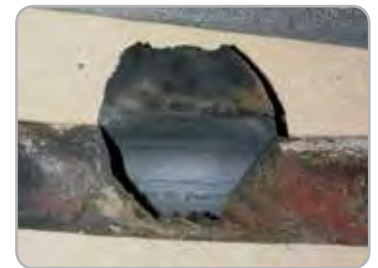
Abb. 2: „Rohrreißer“ – Bei Erreichen einer kritischen Minimalwanddicke öffnet der Dampfdruck das Rohr und das Medium kann wie rechts dargestellt z. B. in einem 2 F-Fall austreten.
