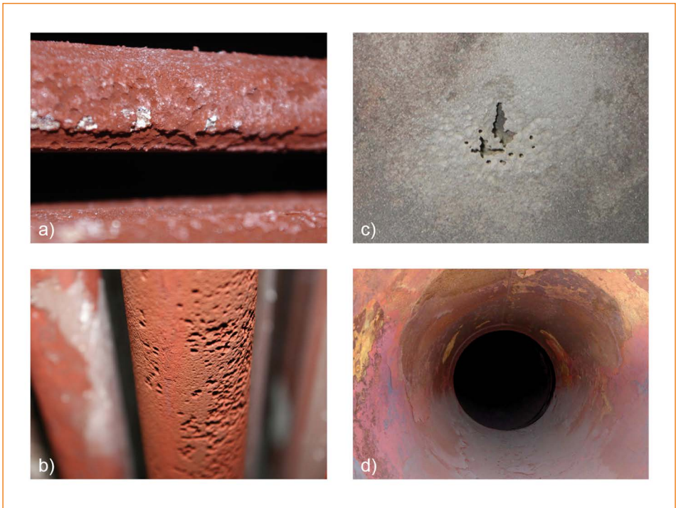
Abb. 3: a) bis d) Schichtenaufbau: Rohrwerkstoff – Korrosionsfront – Korrosionsprodukte – Belag
